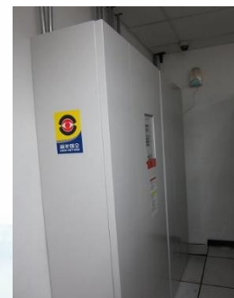
消防系統主機
