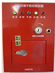
防護區 外部控制箱
